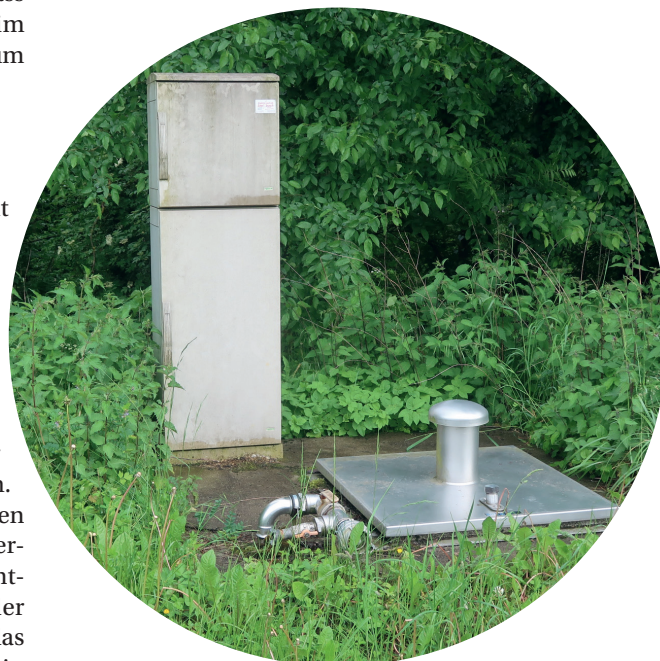
Tiefbrunnen liefern stabil Wasser, allerdings sind hier die Wasserentnahmerechte genau zu prüfen.
